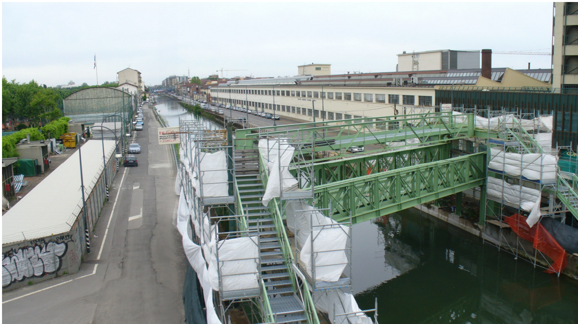
IL PONTE PEDONALE IN FERRO SUL NAVIGLIO GRANDE TRA LA CANOTTIERI MILANO E LA EX RICHARD-GINORI
