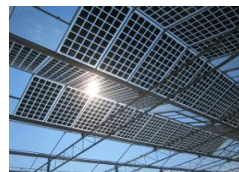
99 – Dettaglio copertura fotovoltaica Progetto: Idroterm
